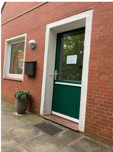
Eingangstür zu schmal, nicht automatisch zu öffnen; Schwelle verhindert das Eindringen von Regenwasser, ist aber für Rollstuhlfahrer ein Hindernis
